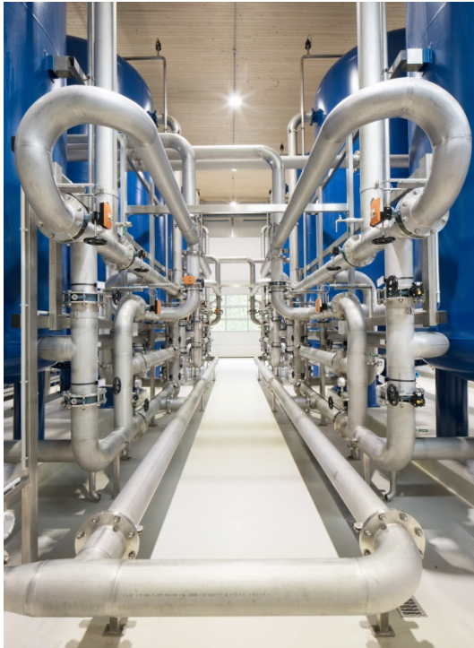
Naturfilteranlage am Brunnenfeld in Wienerherberg
